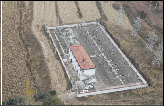
35kV 李元变电站
