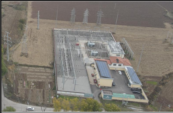
110kV 太岳变电站
