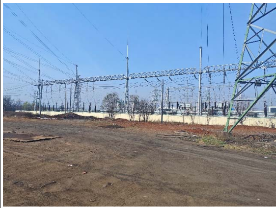
终点（郭庄 220kV 变电站）
