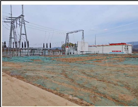
起点（北清登高高压站）
